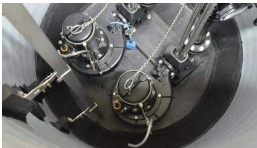
► Pumpen mit Spülrohr
